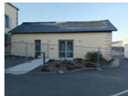
L'annexe après l'incendie
